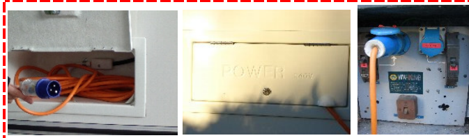
パワーコンセント: ホリデーパーク到着時にここからコードを取り出し接続する。 ②接続した後は鍵を閉める コンセント差込口
